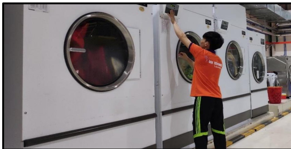
Hình 06: Các máy sấy công nghiệp Unimac của Việt Khánh Laundry
