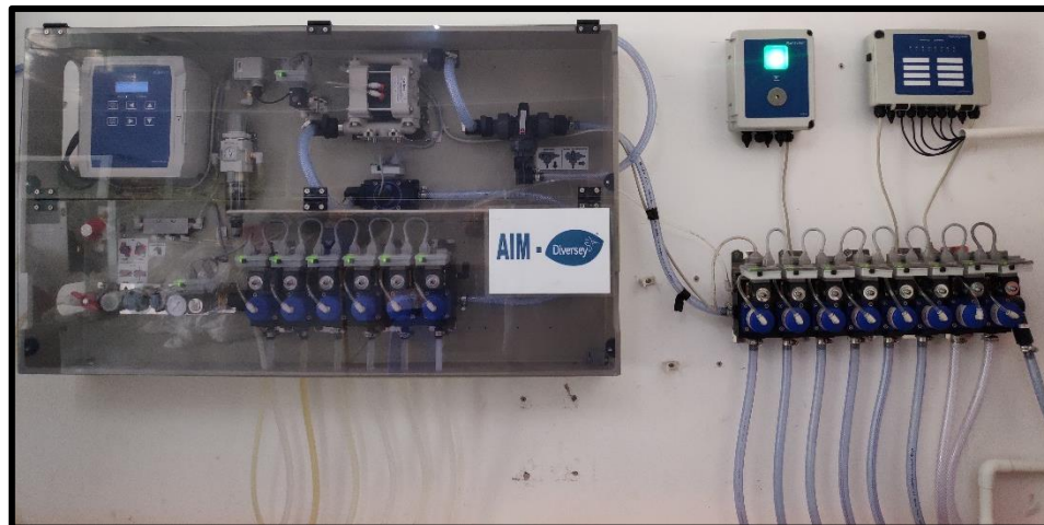
Hình 04: Hệ thống bơm hóa chất tự động WashMulti Air của Việt Khánh Laundry
