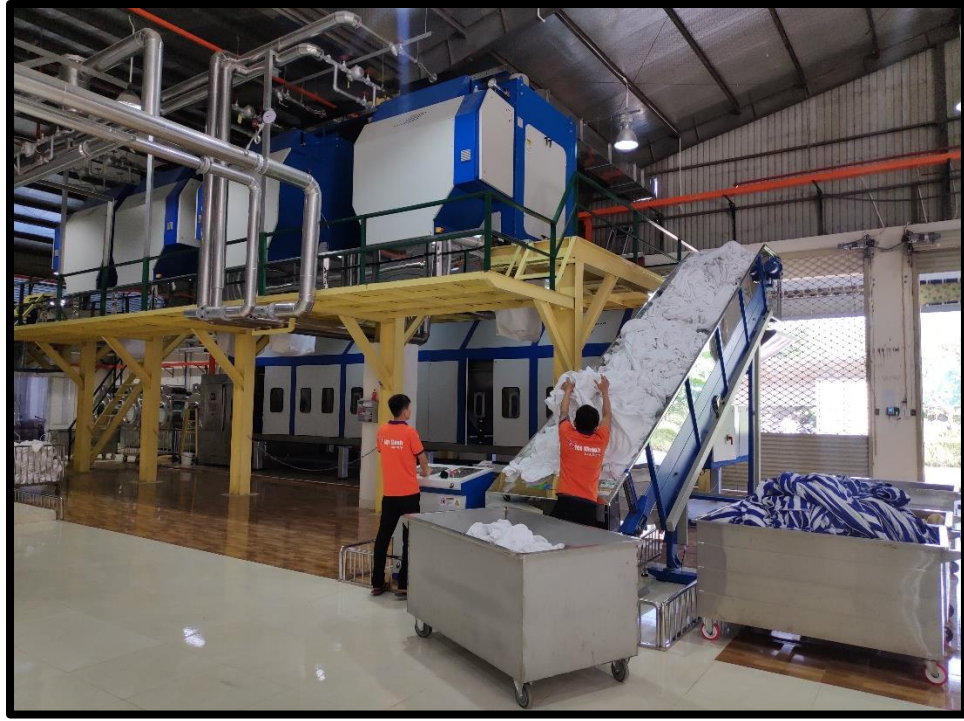
Hình 02: Hệ thống giặt sấy liên hoàn Transflex ECO 60/13 tại Việt Khánh Laundry
